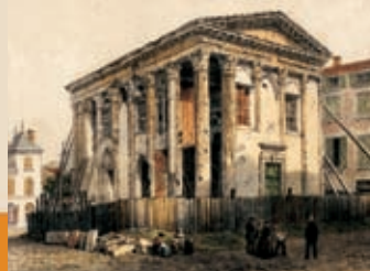
Temple d'Auguste et de Livie en cours de restauration © Musées de Vienne
